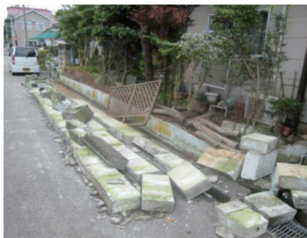
倒壊した石塀
